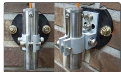
[진동현식 경사계 설치]
