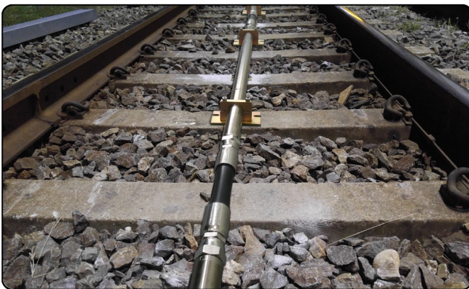
[ACE-RTM 설치 사진]
